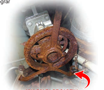
UNA POLEA DE CADENA DE HIERRO FUNDIDO CORROÍDA ILUSTRACIÓN LA VENTAJA DEL ACERO INOXIDABLE
