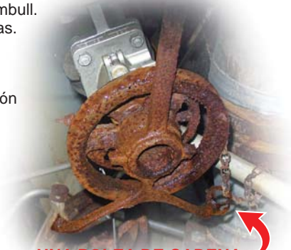
UNA POLEA DE CADENA DE HIERRO FUNDIDO CORROÍDA
