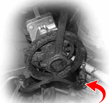
VOLANTINO IN GHISA CORROSO mostrante i vantaggi dell'acciaio inox
